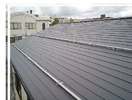
■ 屋根 AT式ガルバリウム0.35厚 ■ 雪止金具・アングル ドブメッキ
